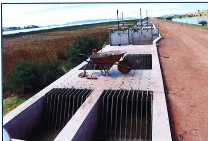
IMAGEN N° 6: CÁMARA DE REJAS Y DESARENADOR DE LA PTAR " EL ESPINAR"
