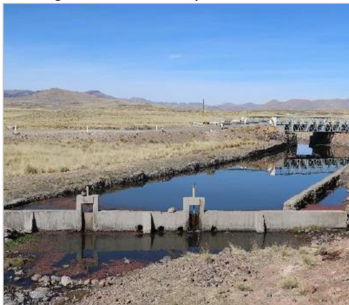
Imagen N° 7: Vista de la captación Chimú Nueva
