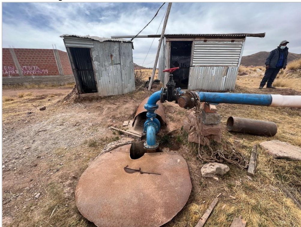
Imagen N° 15: Vista de la cámara de bombeo acondicionada
