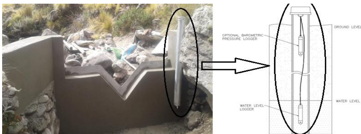
Figura 9. Izquierda (vertedero mixto con tubo protector); Derecha (sensor de nivel tipo Transductor de Presión, protegido por el tubo).
