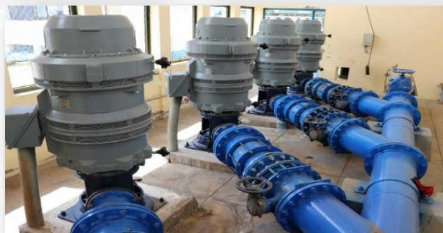
Electrobombas de turbina vertical
