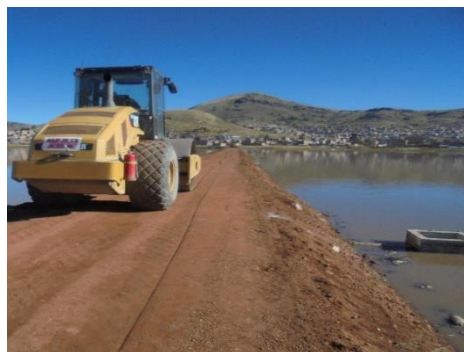
Laguna de Oxidación
