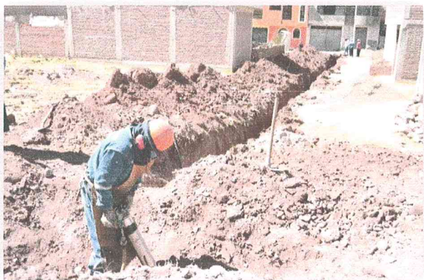
Instalación de red matriz y conexiones de alcantarillado en la urbanización Rinconada de Salcedo desde la Mz. C hasta la Mz. G.
