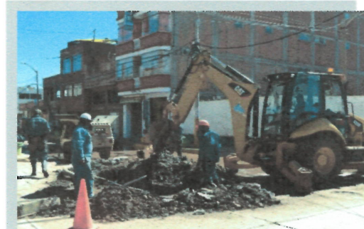
Detección de una fuga no visible Jr. Los Claveles y Branden
