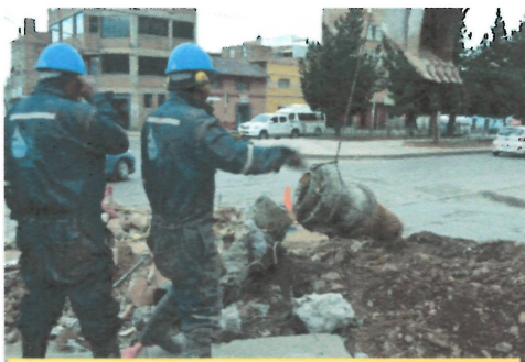
Rotura de red en el Jr. Branden con Laykakota
