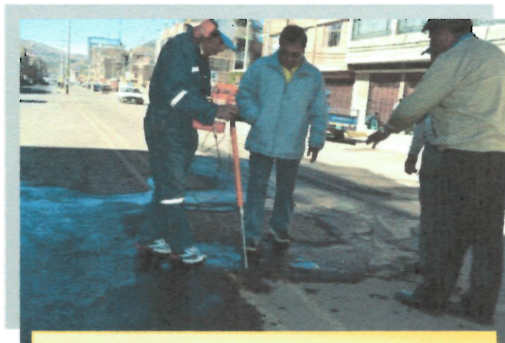
Detección de una fuga no visible Jr. Lampa y Simón Bolívar
